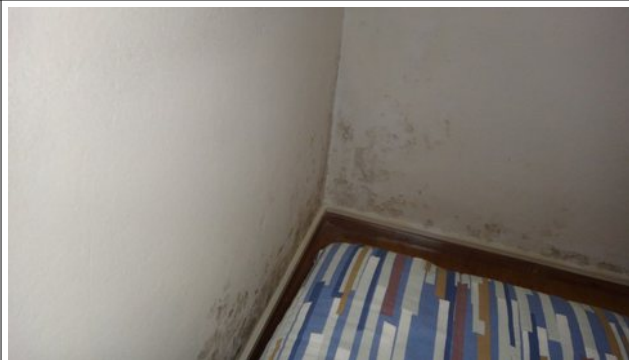
Fig. 8: Schimmel an der Außenwand-Ecke in einem Schlafzimmer
