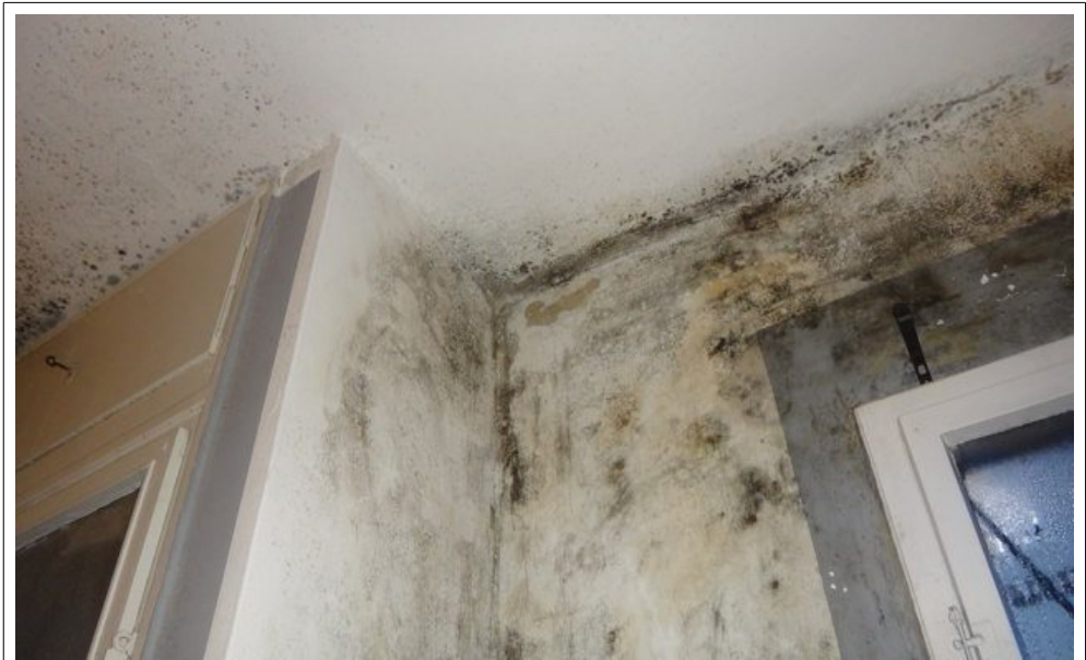
Fig. 2 Schimmel in der Küche eines Altbaues
