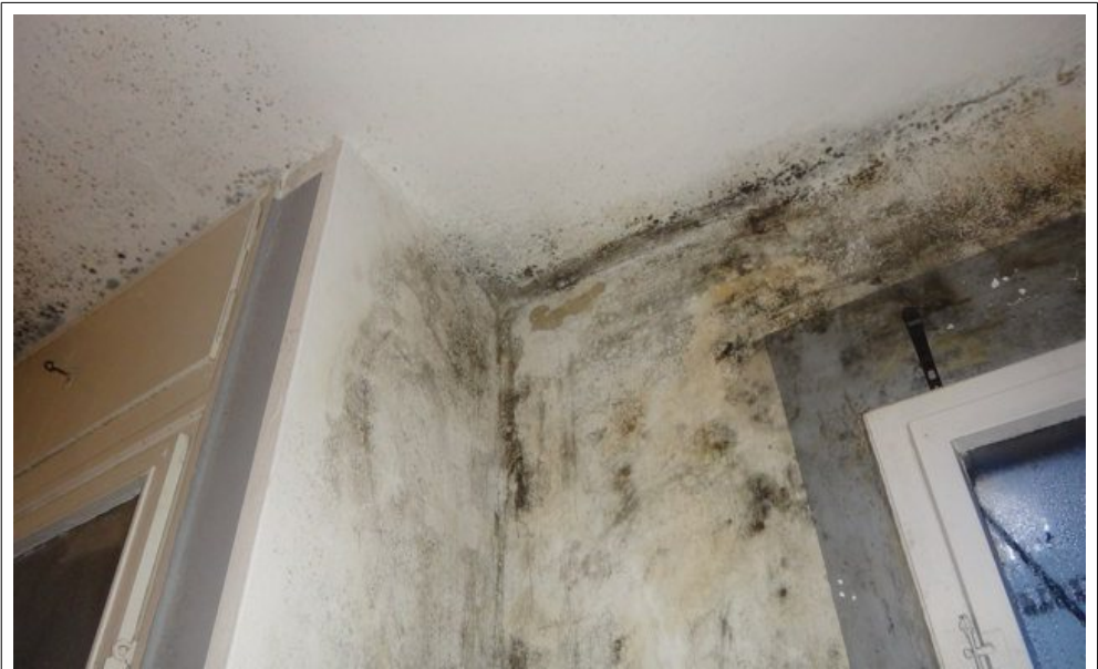
Fig. 2 Schimmel in der Küche eines Altbaues
